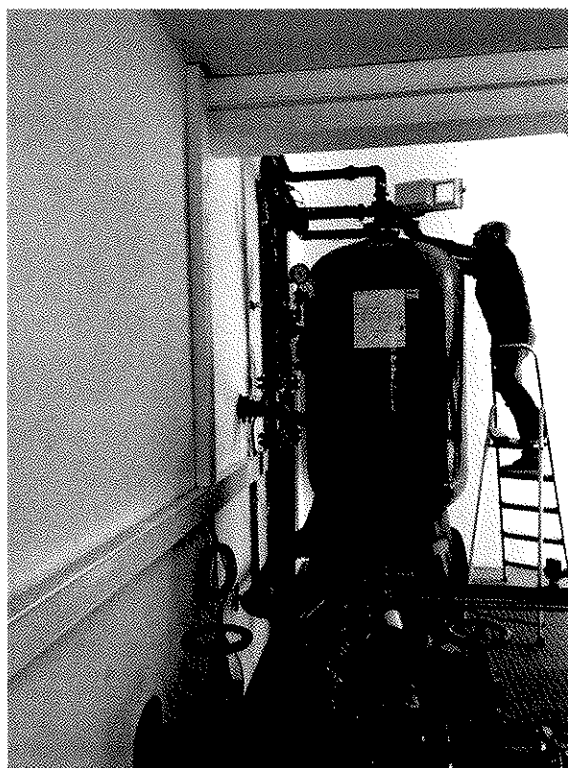
Figura – Instalação de filtro de remoção de ferro e manganês no Sistema de Abastecimento de Faias.
