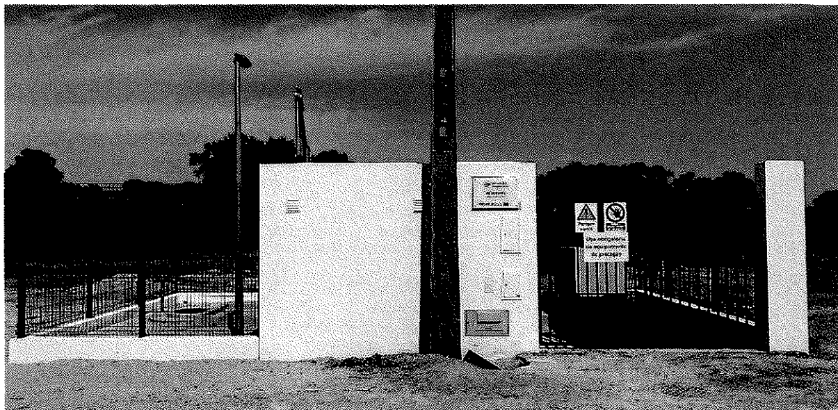
Figura - Estação Elevatória de Águas Residuais de Canha
