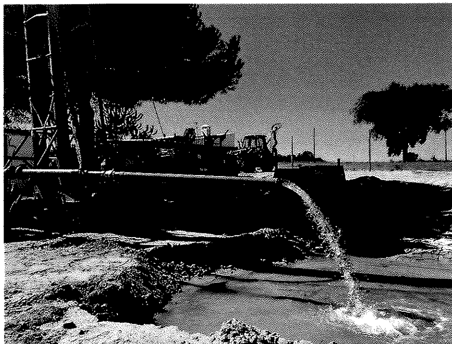
Figura – Ensaio de caudal da nova captação do Sistema de Santo Isidro de Pegões
