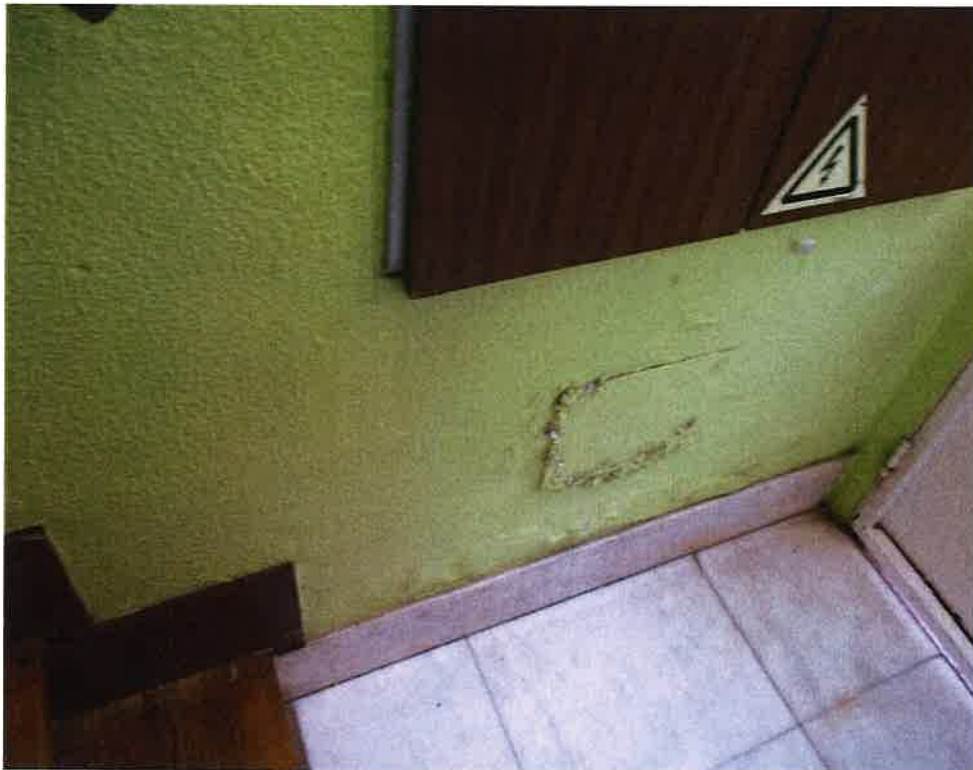
FOTO Nº13- Humidades perto do contador e ligação à terra
