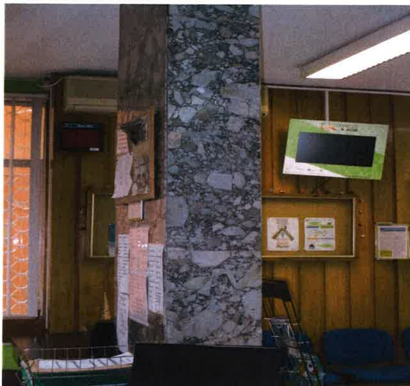
FOTO nº4- As paredes resistentes de alvenaria foram substituídas por uma estrutura com vigas metálicas e 2 pilares.
