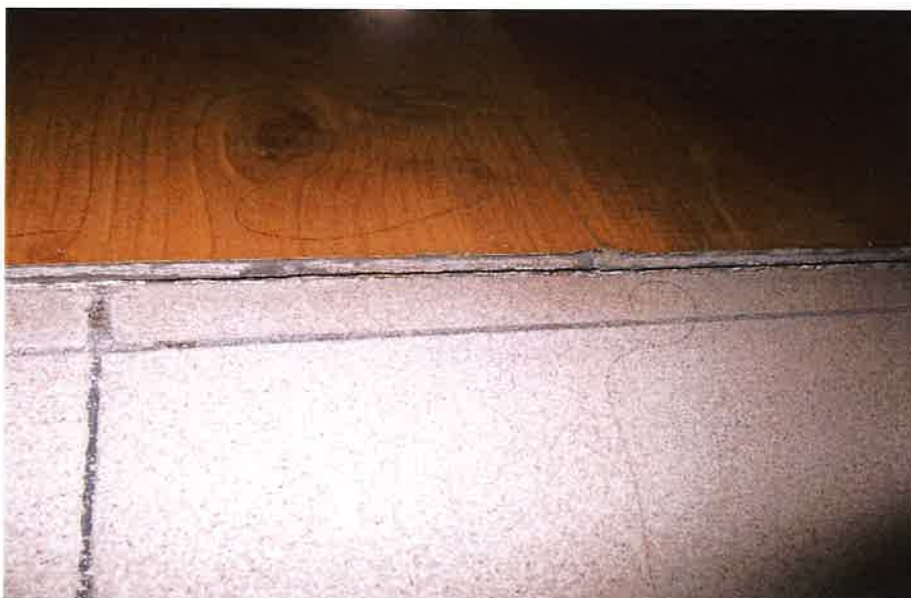
FOTO Nº11- Empolamento do revestimento em laminado de madeira
