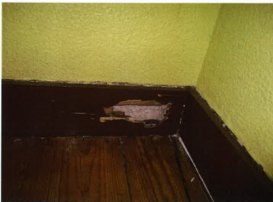
FOTO Nº12- Roda-pé degradado no patim das escadas.
