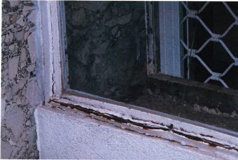
FOTO Nº7- Vão envidraçado no alçado principal com indícios de degradação acentuada
