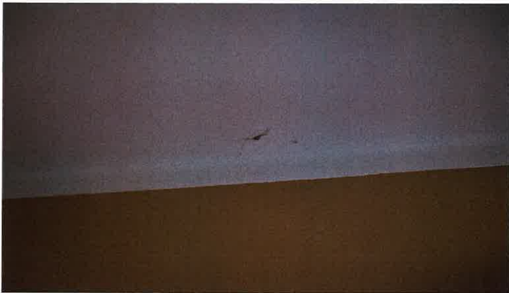
FOTO Nº9- Fenda em tecto falso
