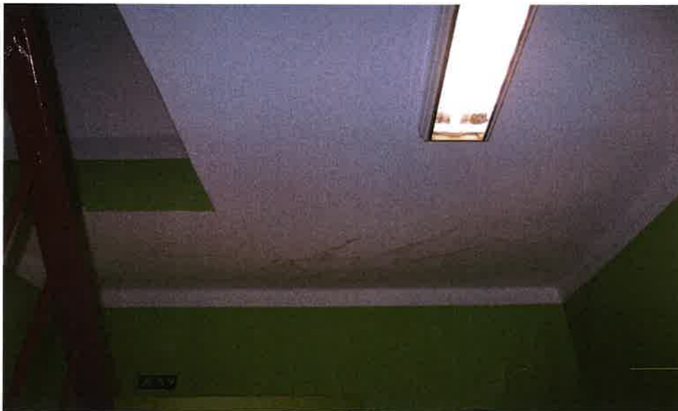
FOTO Nº10- Fendas e infiltrações no tecto das escadas de acesso ao sótão
