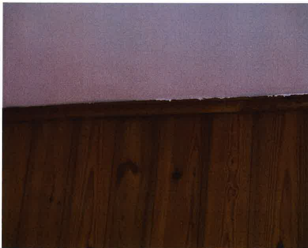
FOTO Nº6- Fenda ao nível do tecto do 3º piso
